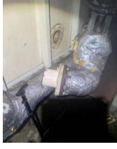
配管設備破損
